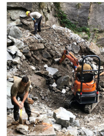
Wasserschäden im Valle di Cocco
