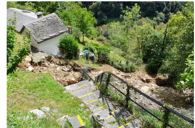
Ein Grossteil der Steintreppe ist durch den starken Regen abgerutscht
