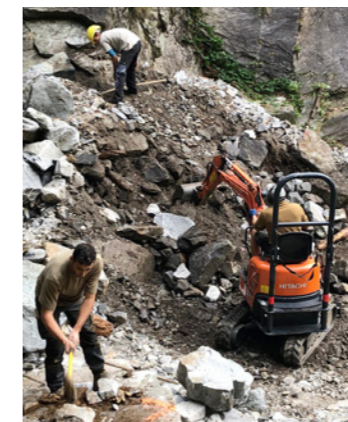
Dommages causés par l'eau dans le Val Cocco
