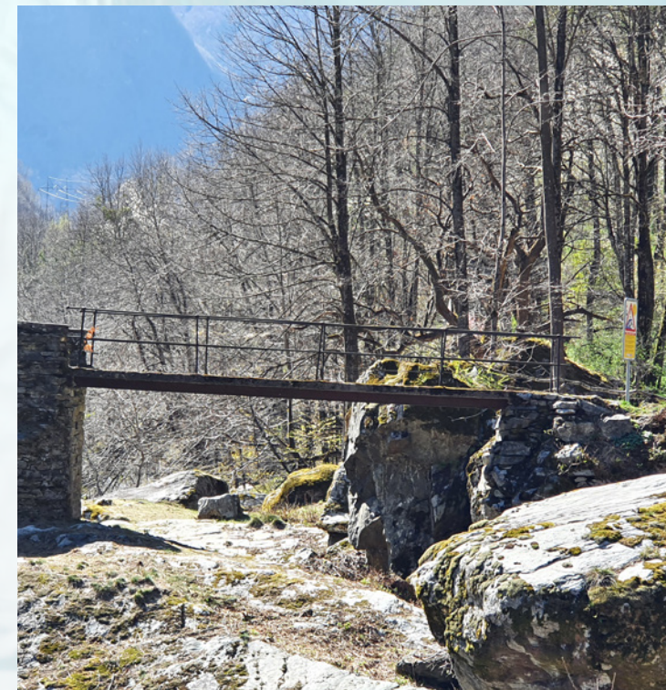
Partie du pont qu'il faut reconstruire
