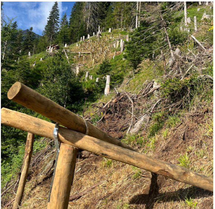
Blick auf einen mit Dreibeinböcken gesicherten Hang (Piano di Peccia – Lavizzara)
