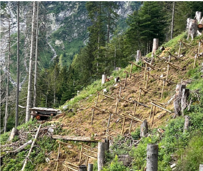
Steiler, abschüssiger Hang, gesichert mit Dreibeinböcken (Piano di Peccia – Lavizzara)
