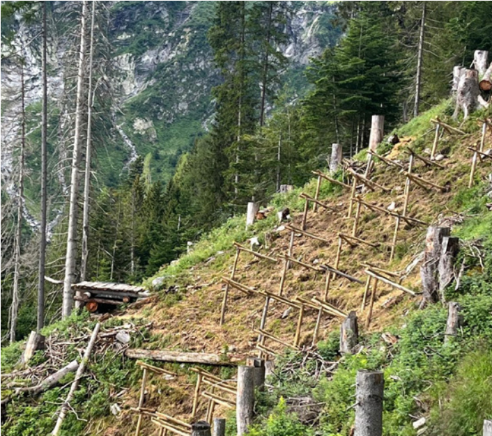
Pente raide et escarpée sécurisée par des trépieds (Piano di Peccia – Lavizzara)
