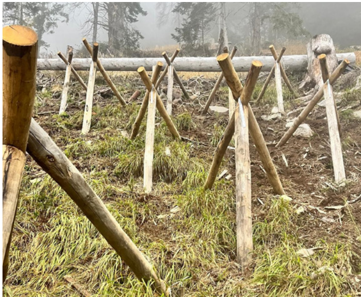
Trépieds: œuvres contre la fonte des neiges (Piano di Peccia – Lavizzara)
