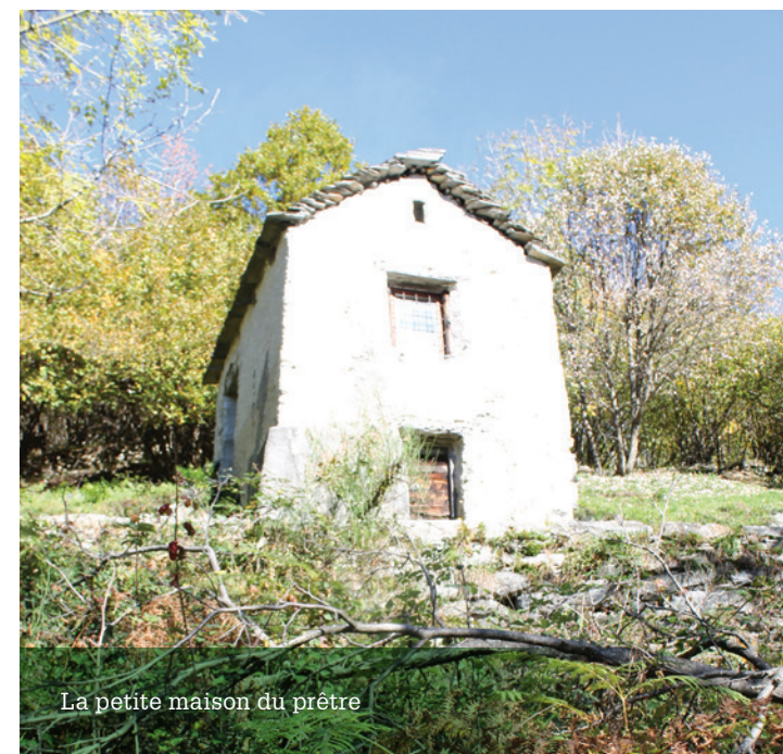
Le crépi extérieur doit être renouvelé
