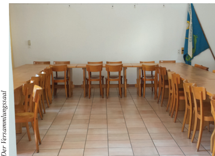
Türen und Fenster, die erneuert werden müssen
