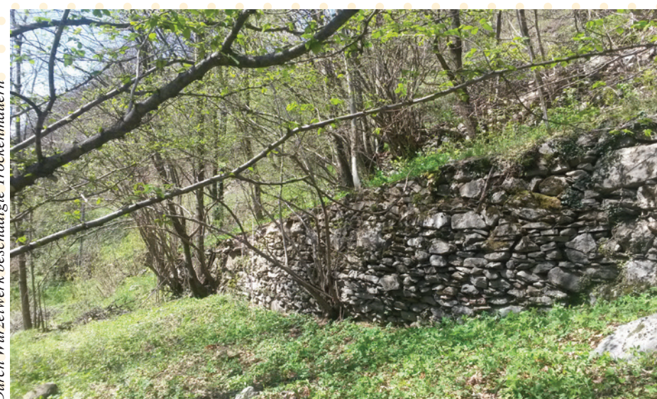
Durch Wurzelwerk beschädigte Trockenmauern
