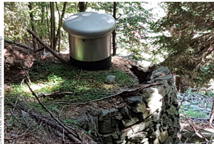
Während der Arbeiten haben schwere Unwetter die Abdeckung des Sammelbeckens beschädigt
