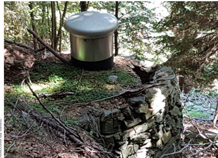
Au cours des travaux, de fortes précipitations ont endommagé la protection du bassin.
