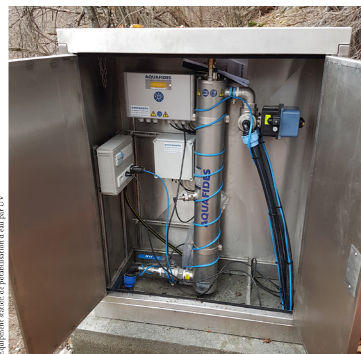
Équipement station de potabilisation d'eau par UV
