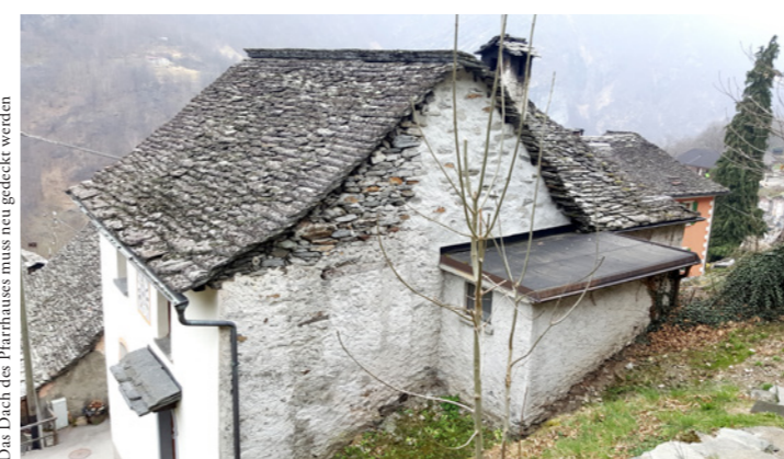
Das Dach des Pfarrhauses muss neu gedeckt werden
