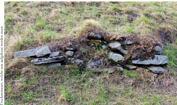
Trockenmauer, welche neu aufgebaut werden muss
