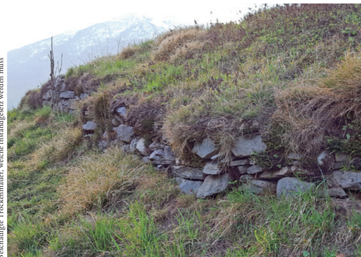
Beschädigte Trockenmauer, welche instandgesetzt werden muss
