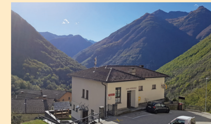
Les infiltrations d'eau demandent interventions urgentes
