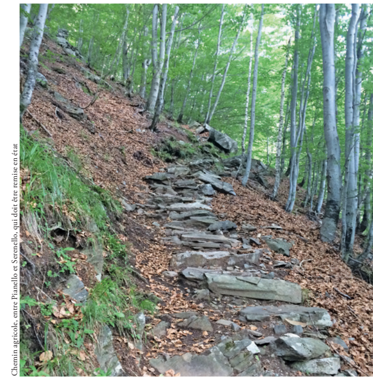
Chemin agricole, entre Pianello et Serenello, qui doit être remis en état
