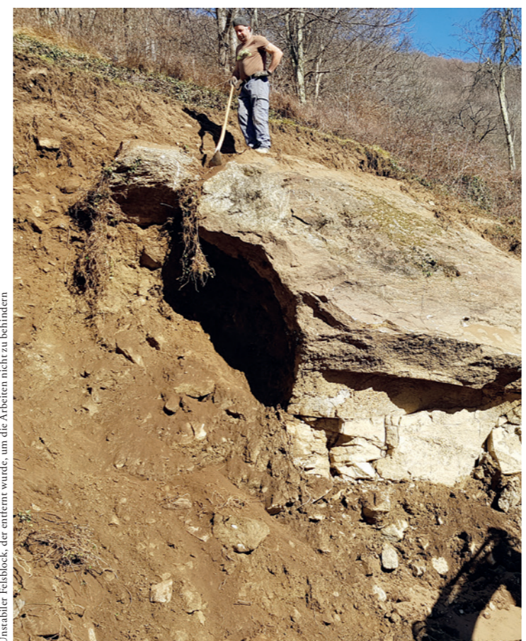
Unstabiler Felbbleck, der entfernt wurde, um die Arbeiten nicht zu behindern
